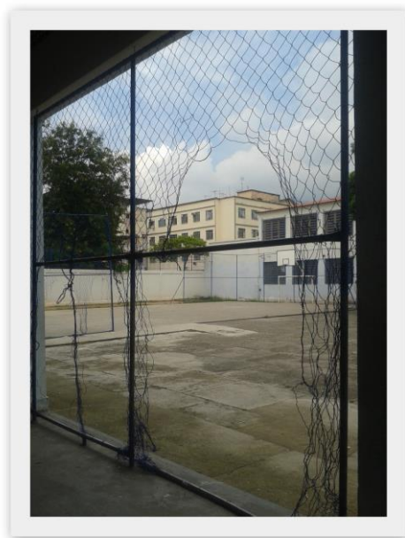
Figura 19 – Depredação da grade de proteção da quadra de esportes
