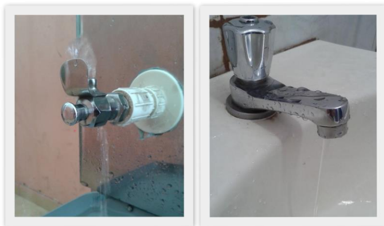
Figura 32 – Vazamentos de água em bicas e bebedouros
